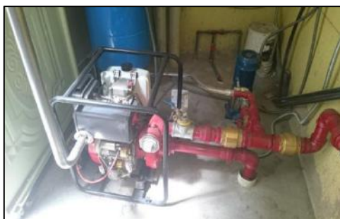
Fotografía No. 31: Bomba de alta presión DIESEL TEMCO Coordenadas UTM: 772952.49 E; 9969776.78 N
