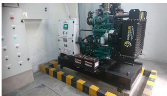
Fotografía No. 29: Planta generadora de energía eléctrica Coordenadas UTM: 772989.72 E; 9969763.93 N
